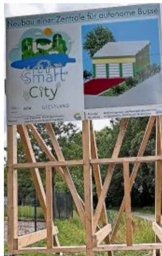
Das Bauschild steht schon: Die Stadt Geestland baut in Beers eine Garage für die autonomen Busse. FOTO: STADT GEESTLAND
