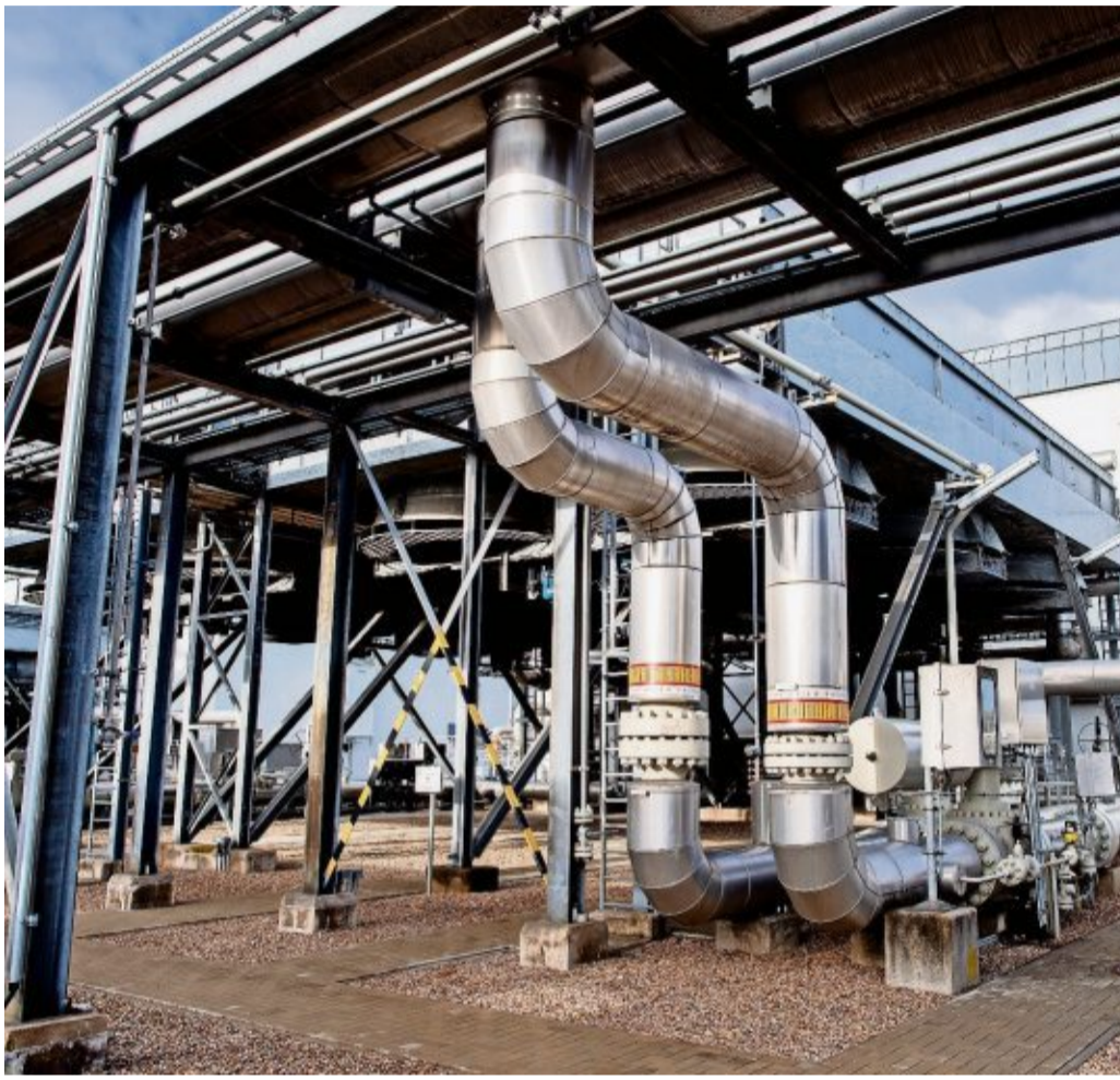
Technische Anlagen zur Verdichtung von Erdgas stehen auf dem Gelände des Erdgasspeichers Rehden. Bei der Speicheranlage handelt es sich um den größten Erdgasspeicher in Westeuropa. FOTO: DITTRICH
