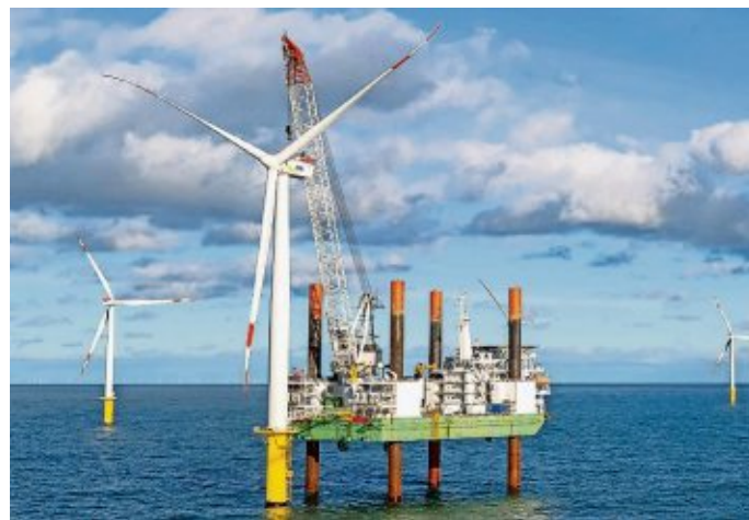
Der Offshore-Windpark Riffgat bei der Insel Borkum war der erste kommerzielle deutsche Windpark in der Nordsee. FOTO: SCHULDT/DPA
