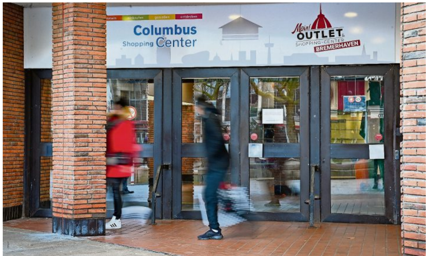
Eingang von der Unteren Bürger zur Oberen Bürger: Mit Beginn der Abrissarbeiten sollen die Türen dicht bleiben. FOTO: SCHESCHONKA
