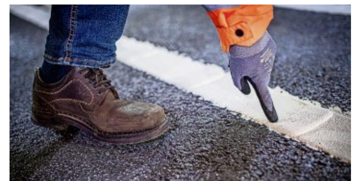
Die Mittellinien und Randstreifen der Straßenmarkierung sind mit sogenannten Rüttelstreifen versehen, um Verkehrsteilnehmer am Überqueren der Fahrbahn zu hindern und zu warnen. FOTO: HARTMANN
