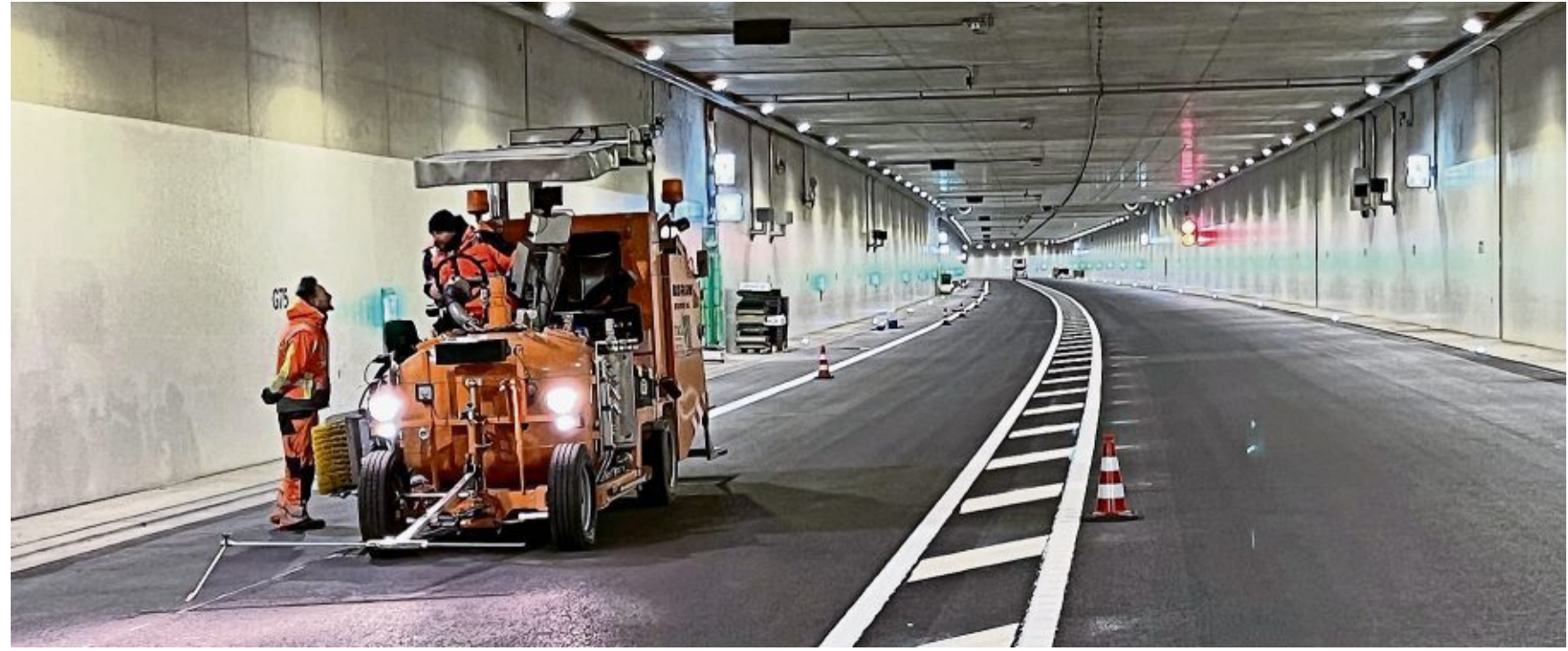
Aus einer Kaltplastik werden Bremerhavens erste Rüttelstreifen gespritzt. Mit der Markierung gelten die Bauarbeiten im Hafentunnel als abgeschlossen. FOTO: BROCKMANN
