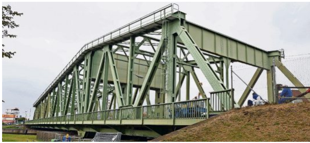
Ein Bild aus alten Zeiten: Die Drehbrücke brach im April 2021 zusammen. Nun laufen die Planungen für einen Neubau. Sie soll der alten Brücke ähnlich sehen. FOTO: SCHEER
