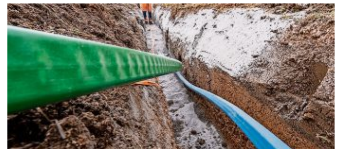
Mit viel Aufwand: Glasfaserkabel werden in die Erde verlegt. Der Ausbau soll beschleunigt werden. FOTO: WEIGEL/DPA
