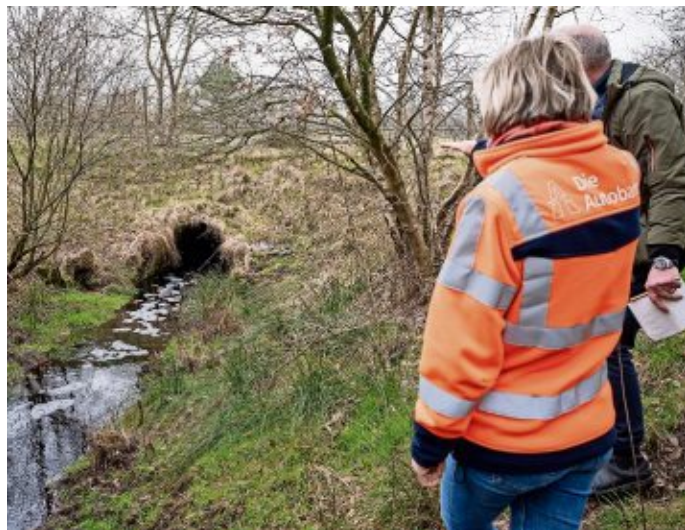
Gisela Schütt am Grienbergsmoorgraben, der unter der A27 hindurchfließt. Das Stahlgewölbe darüber ist an vielen Stellen durchgerostet.
