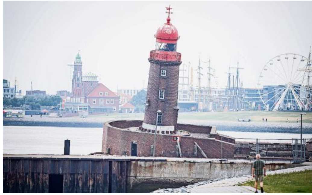
Großer Schock: Die Nordmole sackte am 18. August 2022 ab. Für die Bremerhavener war das ein Stich ins Herz.
