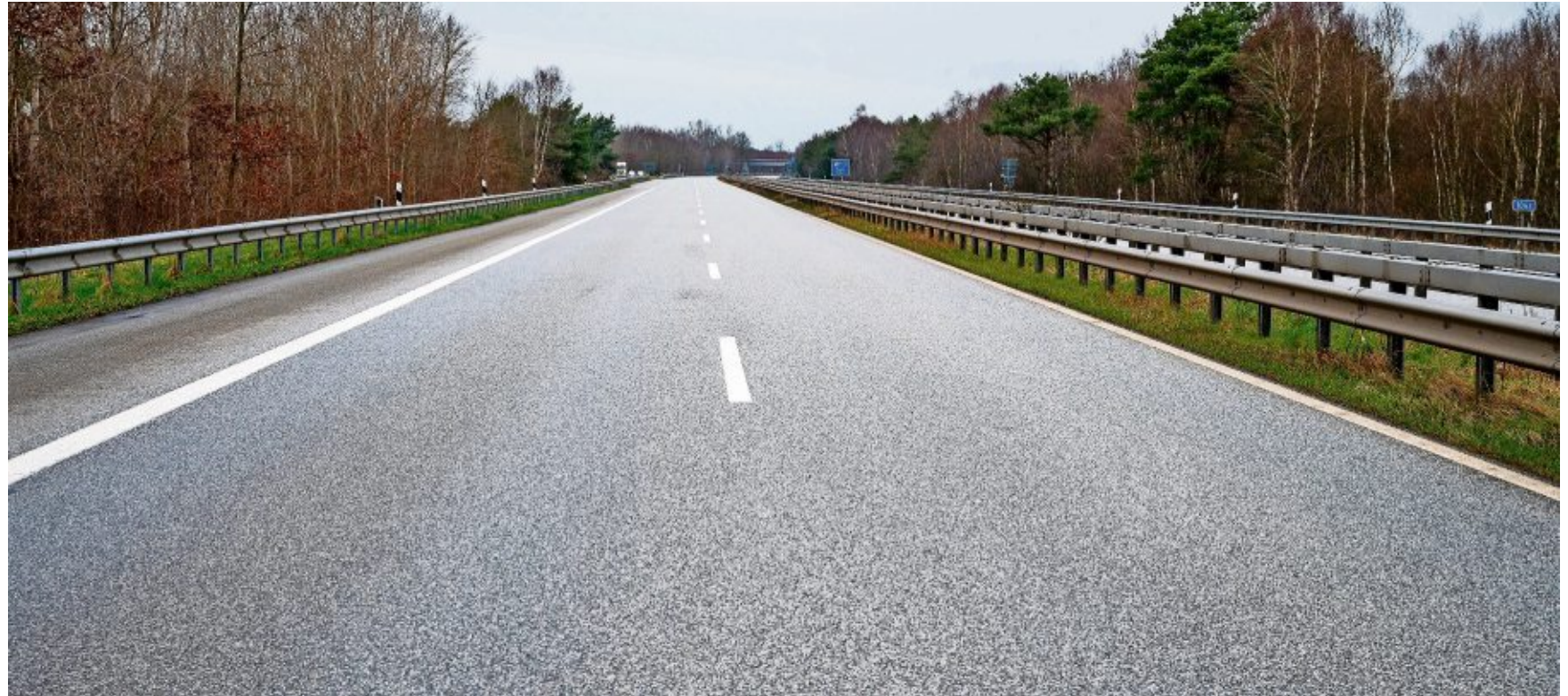
Voll gesperrt: Die A 27 zwischen Uthlede und Hagen wurde etwa 1,5 Kilometer vor der Abfahrt Hagen unterspült. Die Fahrbahnen könnten absacken.
