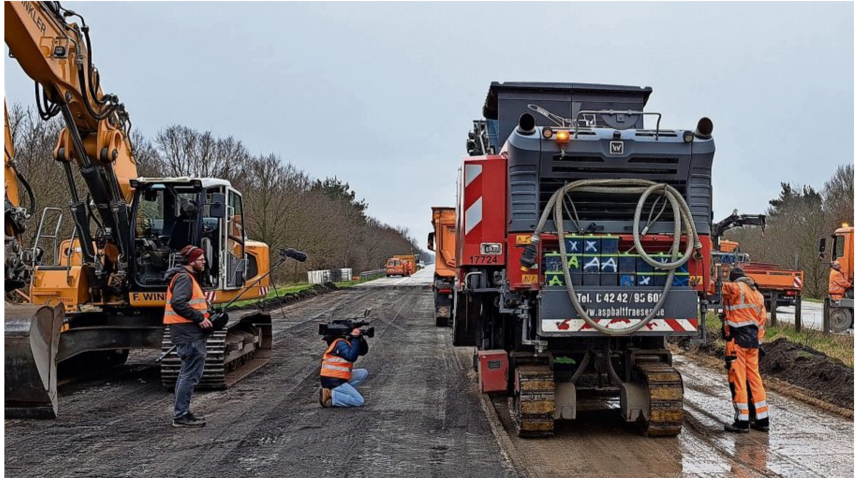
Extrem laut, aber effektiv: Eine Asphaltfräse trägt die Asphalt- und Betonschichten auf der A 27 über dem maroden Grabendurchlass ab.
