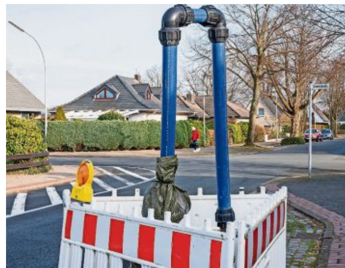
Der Versuchsbrunnen an der Flettnerstraße pumpt seit 2023 nicht mehr. FOTO: SCHECHONKA
